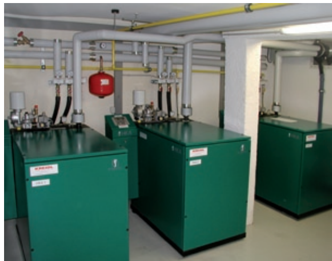
Figura 4: Equipo de microcogeneración
