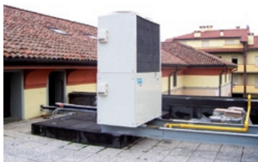
Figura 3: Bomba de calor en edificio de oficinas
